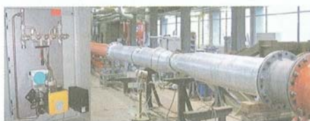
Die Dampfverrechnungsmessung mit Venturirohr nach ISO 5167 ist das derzeit verlässlichste Verfahren.
