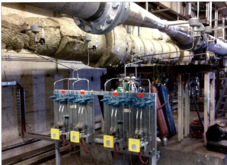
Abb. 1: Erfahrungen belegen, dass Messungen nach dem Wirkdruckprinzip für Abrechnungsmessungen und hochwertige Bilanzierungs- bzw. Kontrollmessungen am besten geeignet sind.
